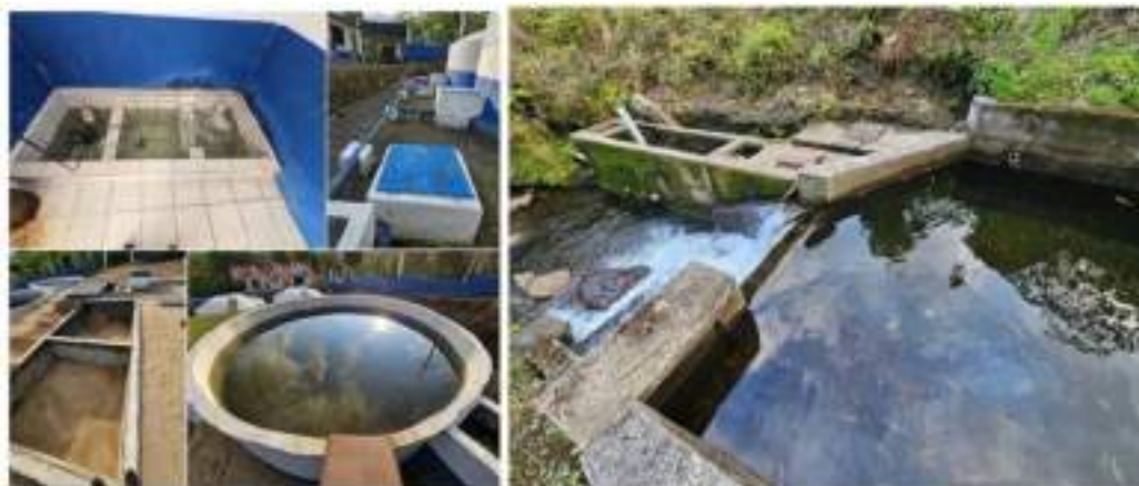
Fotografía 66: Sistema de agua que abastece a la cabecera cantonal (izq. Planta de tratamiento, der. Captación de agua)
