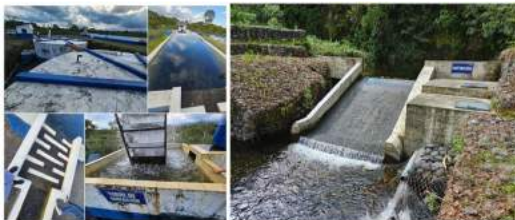
Fotografía 67: Sistema de agua que abastece a las comunidades (izq. Planta de tratamiento, der. Captación de agua del río amarillo)
